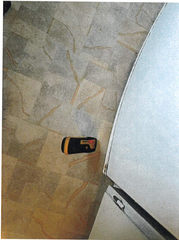
Fuktmätning i köksgolv i lgh på övervåningen.
