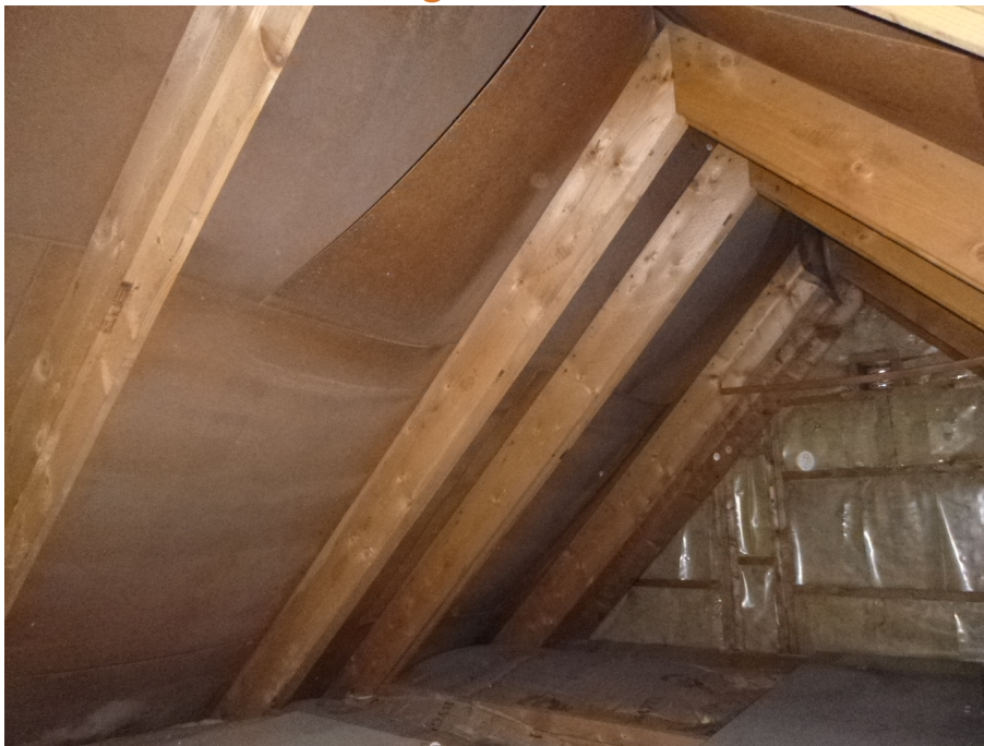
Mikrobiell påväxt i mindre omfattning, några boardskivor har delvis släppt.
