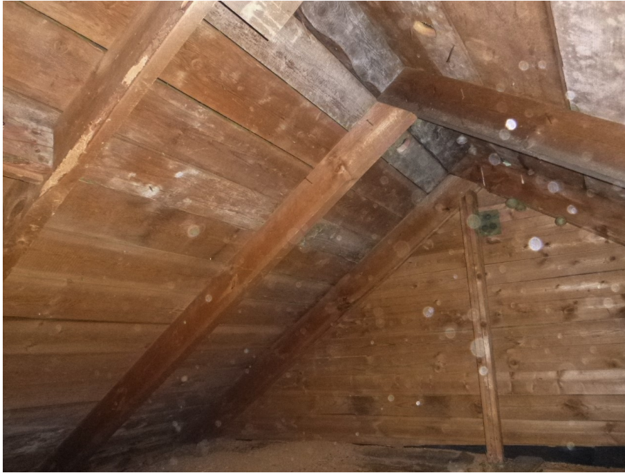
Mikrobiell påväxt i mindre omfattning på underlagstak.
