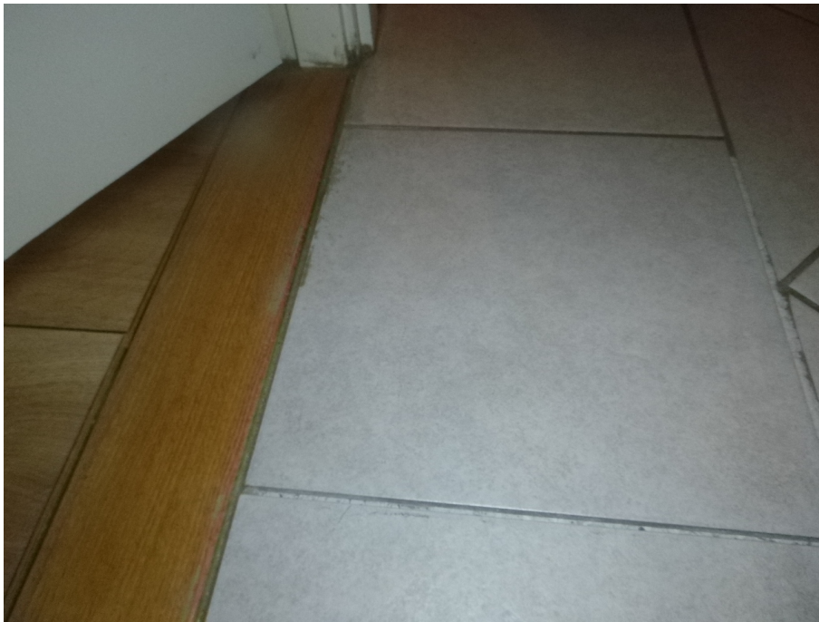
Sprickbildning i fogar, bristfällig vidhäftning mot underlag samt låg tröskel, duschrom på entréplan.
