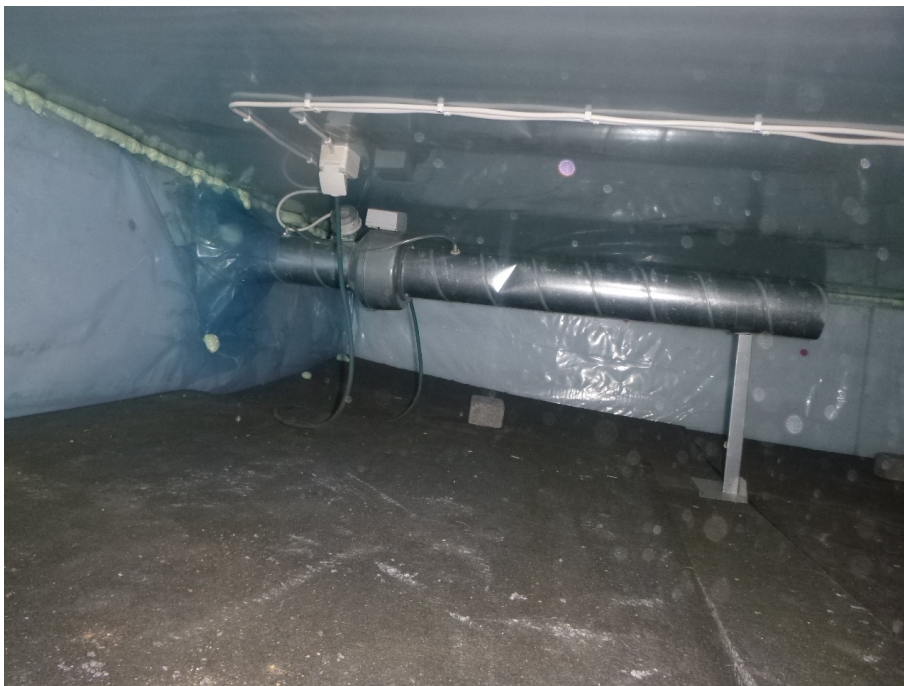
Mekaniskt ventilerad krypgrund.
