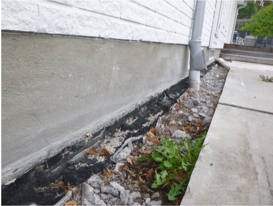
Avsaknad av täcklist ovan fuktisoleringsmatta.
