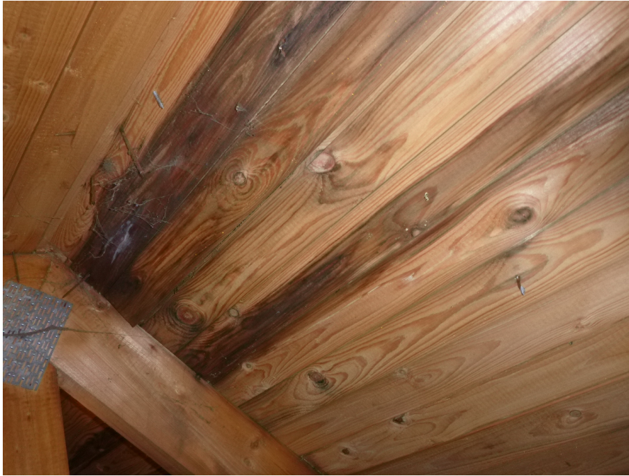
Fuktanvisningar/missfärgning undertak, vindsutrymme.
