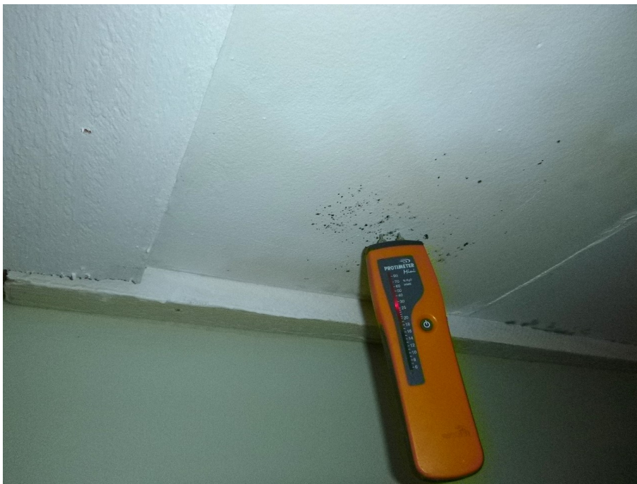
Förhöjda fuktvärden intill yttre långsida, innertak garagebyggnad.
